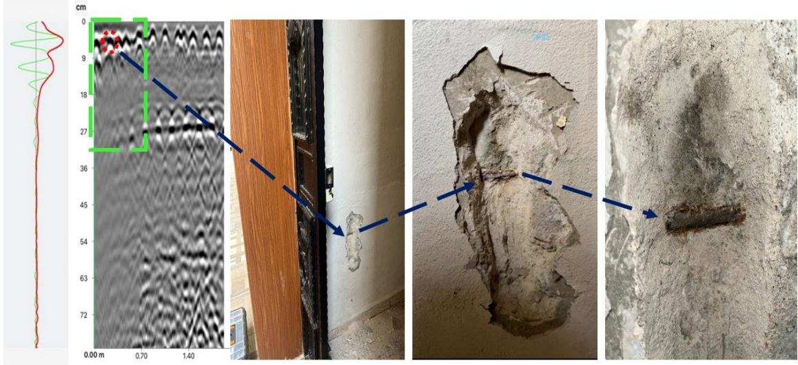
Şekil 3 Radar sonuçları dikkate alınarak yapılan sıyırma işleminden sonra mevcut betonun ve etriyenin gösterimi.
